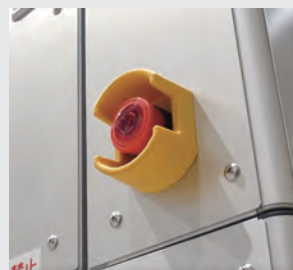
非常停止 ボタン
