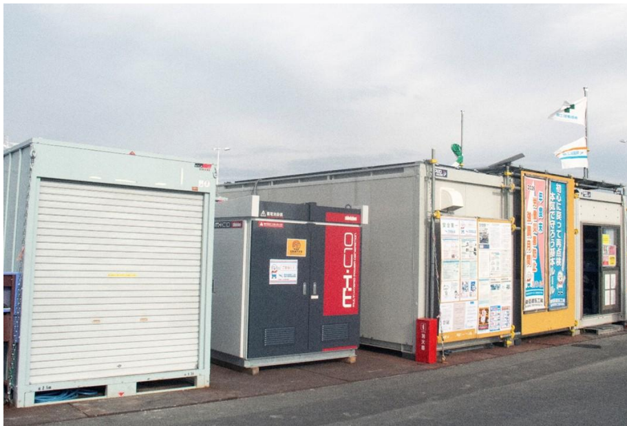
工事現場仮設事務所に設置されたマルチハイブリッドシステム
