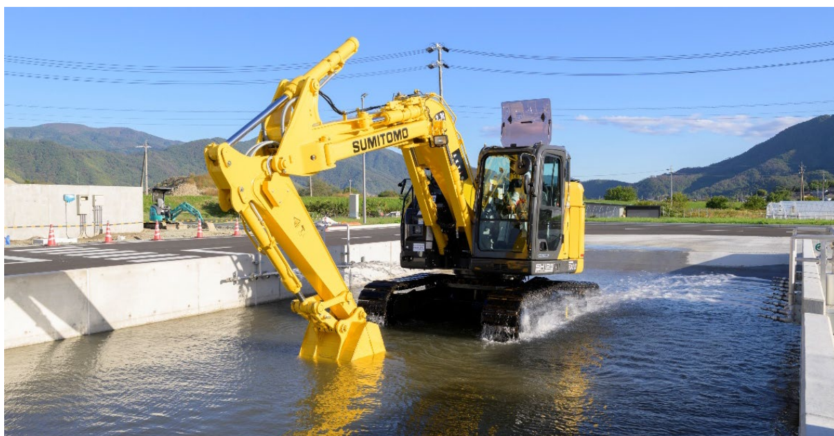
【洗車プールと洗車ノズル】
