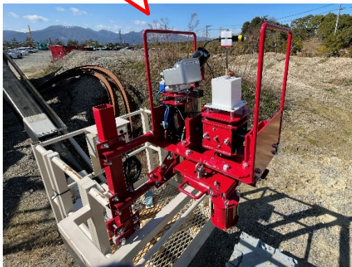
【写真 5-1】機器設置状況
