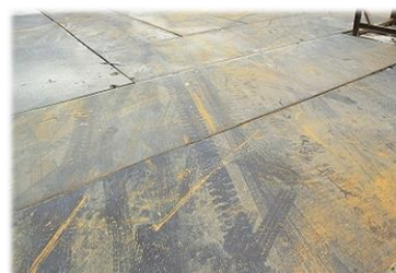
敷鉄板の段差
