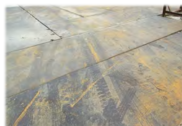
敷鉄板の段差
