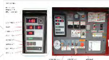
実際の発電機のパネル
