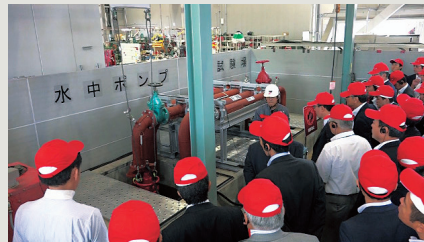
水中ポンプ設備スペース
