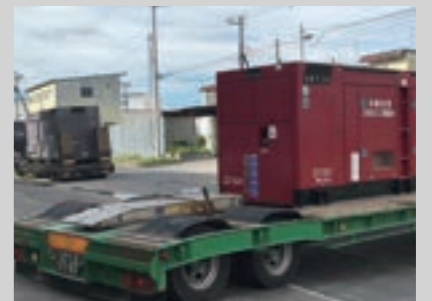
北海道工場から次々に発電機が出庫されていく
