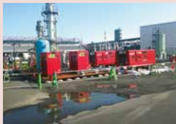
製油所に設置された代替コンプレッサシス テム。停電時も、陸上出荷場のローリーへの燃 料供給を止めずに済むようになった。
